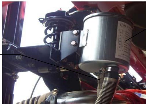
Tubería de baja presión
