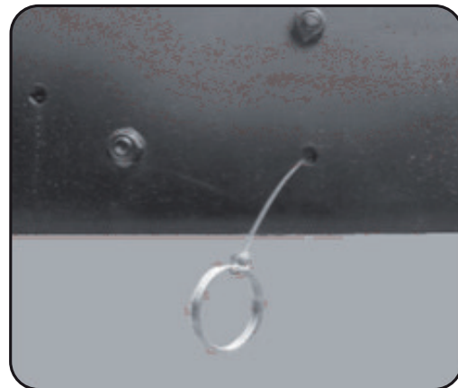
Кран слива конденсата из воздушного ресивера
