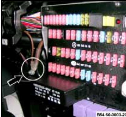
Ponto de massa na central elétrica
