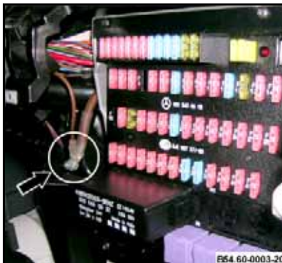
Ponto de massa na central elétrica
